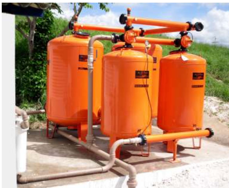
Sistema de Dupla Filtração instalado no Centro de Referência em Aquicultura, CODEVASF - Porto Real do Colégio/AL. Vazão: 10 m 3 /h (2,8 L/s)
