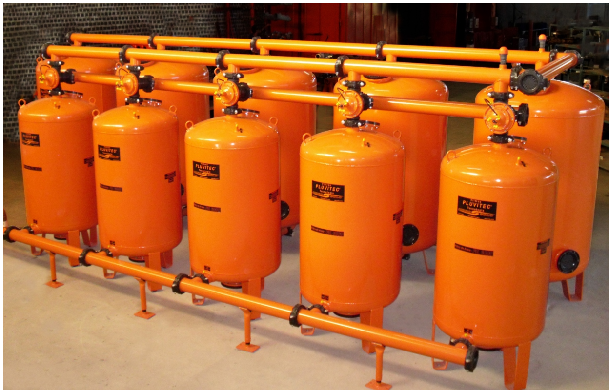
Sistema de Dupla Filtração instalado em Igreja Nova/AL. Vazão: 30 m 3 /h (8,3 L/s)
