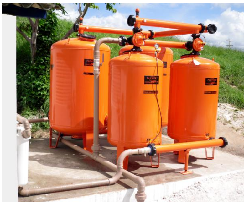
ETA compacta instalada no Centro de Referência em Aquicultura, CODEVASF - Porto Real do Colégio/AL. Vazão: 10 m 3 /h (2,8 L/s)
